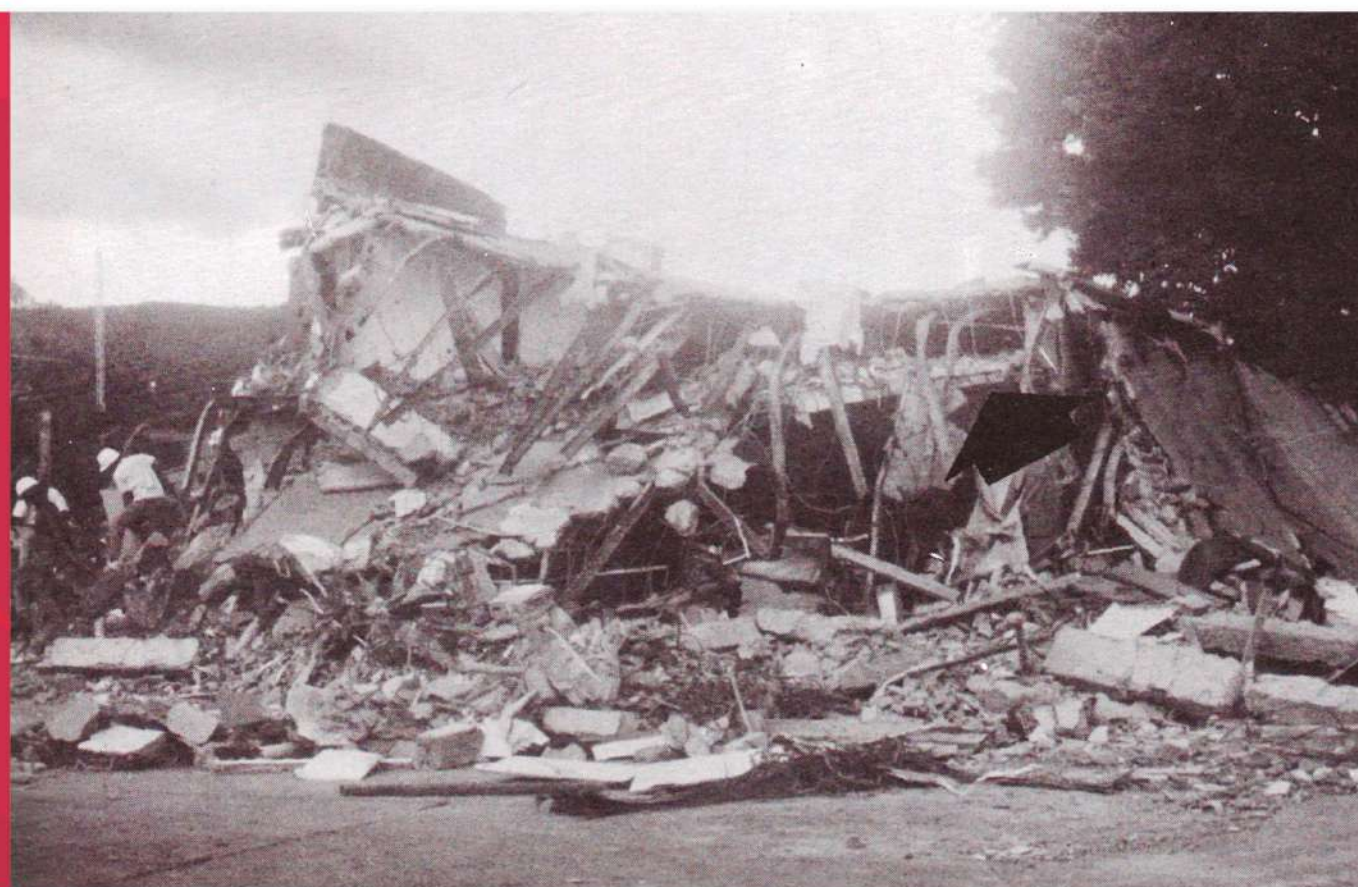
Colapso parcial del edificio del Banco Orinoco, Cariaco.
