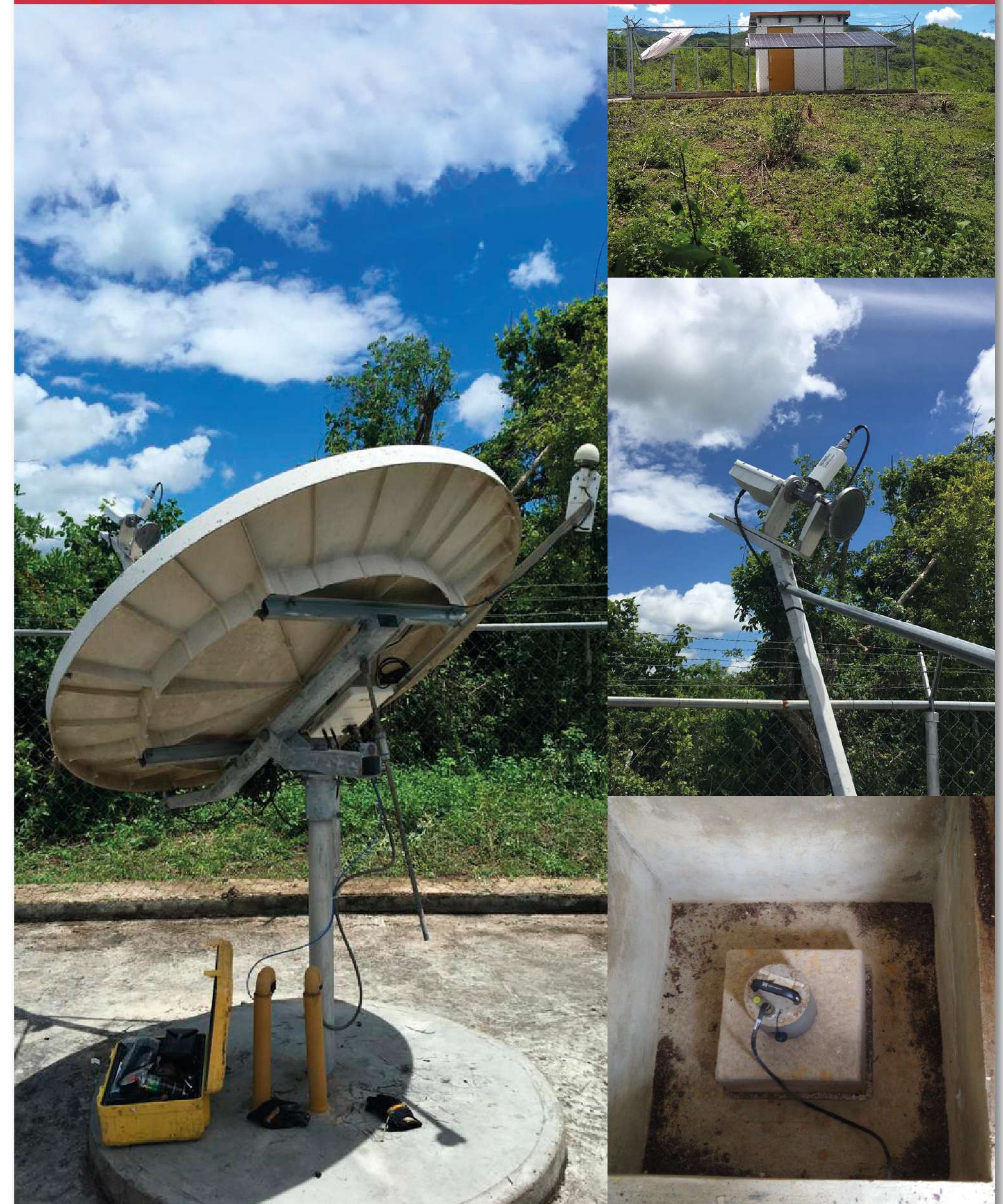
Antena de transmisión. Fuente: Miguel Castro (2019).
