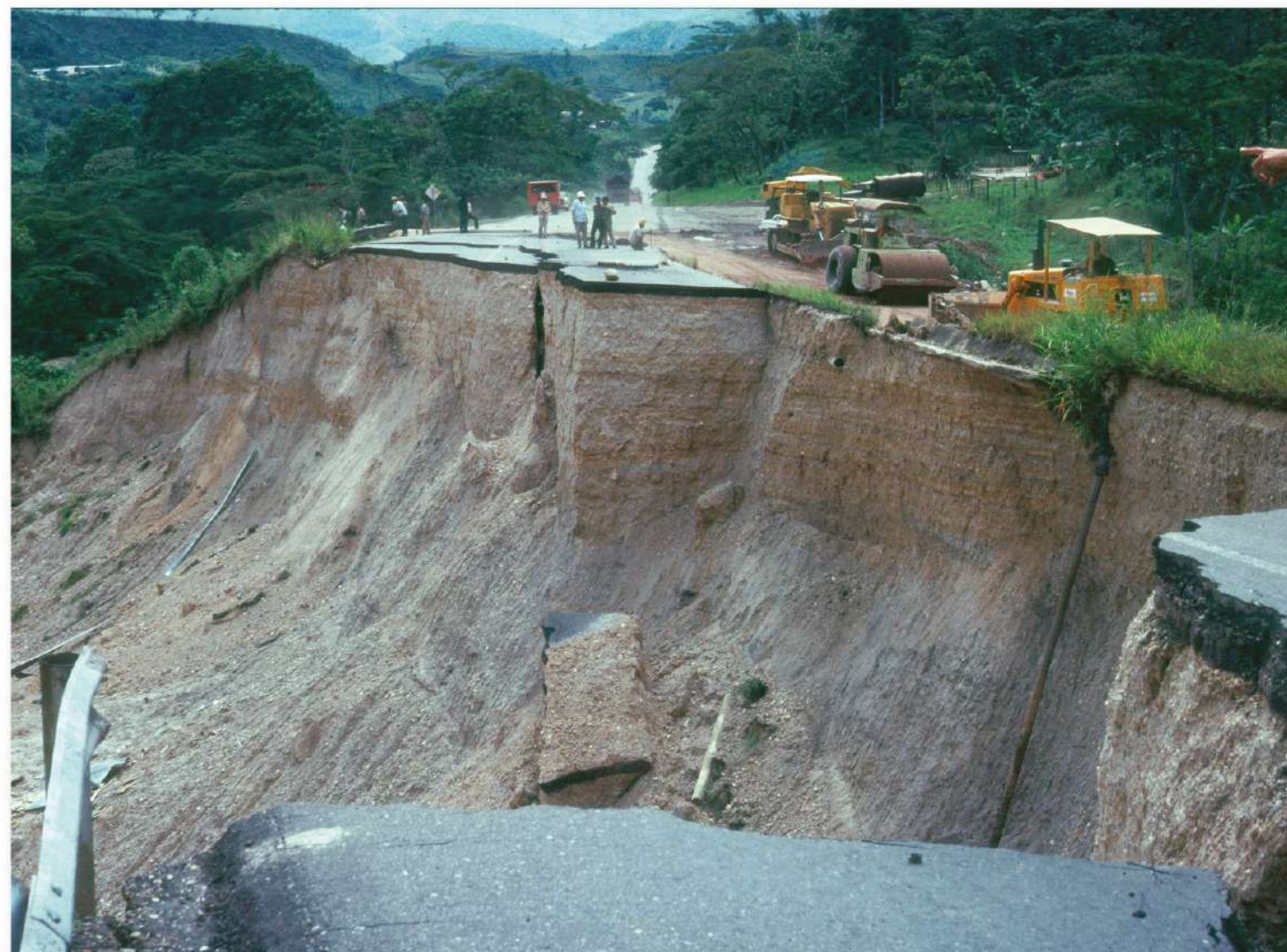
Colapso cosísmico del terraplén de San Josesito durante el sismo del 18/10/1981, con destrucción del barrio marginal ubicado al pie del talud por un flujo de barro. Fuente: Roberto Centeno (1981).
